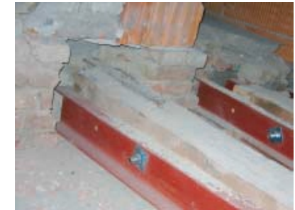
Bild 6: Justizanstalt Wr. Neustadt, zusammengesetzte Verbunddeckensysteme: seitliche Stahlaschenverstärkung kombiniert mit verdrübelten Stahlfaserbetondruckgurt.
