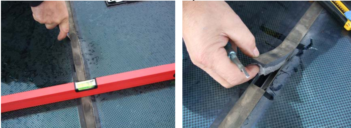
a) pohled na tmelovou spáru, která má bubliny b) nevhodný tvar podložného profilu a malá mocnost tmelu
