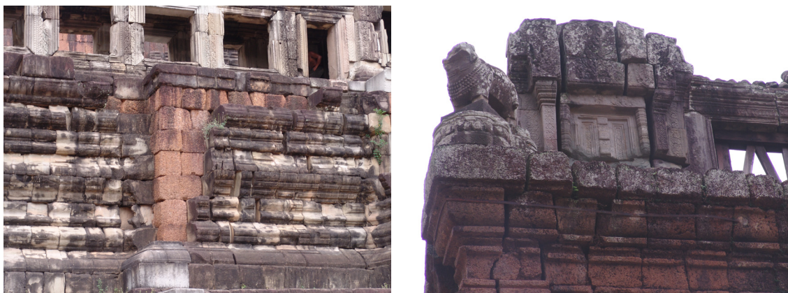
Obr. 3 Delaminace pískovcového a lateritového zdiva (chrám Baphuon, pol. 11. stol.); defragmentace zdiva z pískovcových kvádrů (chrám Phimeanakas, konec 10. st.)
