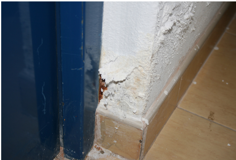
Foto č. 1 Pohľad na následky vlhnutia stien v oblasti sokla
