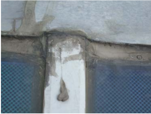
Obrázek 5 - pohled na nevhodně „utěsněné“ oplechování tmelem
