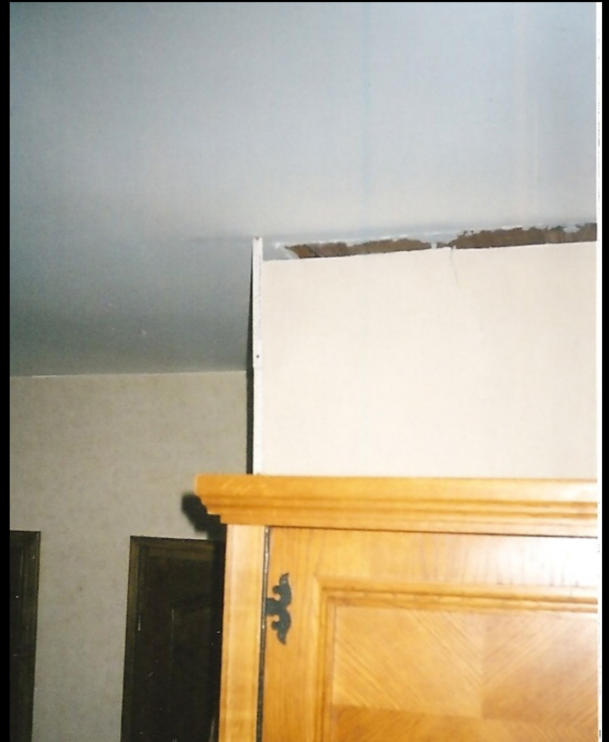
A nappali válaszfalának süllyedése
