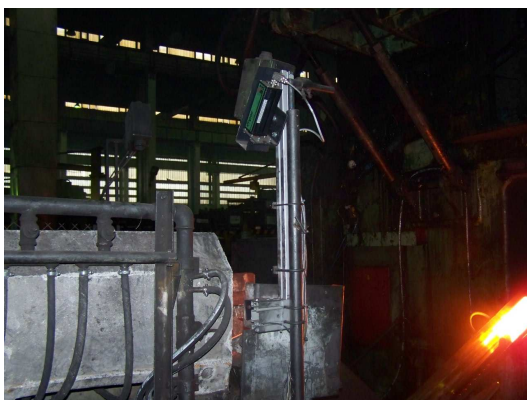
Kovácsológép mellé telepített hőmérséklet mérő berendezés
