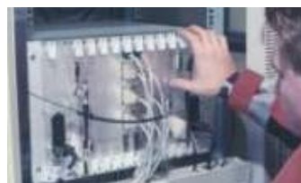
EBI Lock Elektronische Stellwerke
