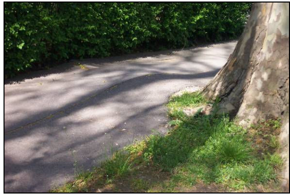
2. ábra: A védett nagy fák gyökerei felnyomják a burkolatot, a járda néhány szakaszon járhatatlan, a gyalogosok az úttestet használják (Győr, Damjanich utca)
